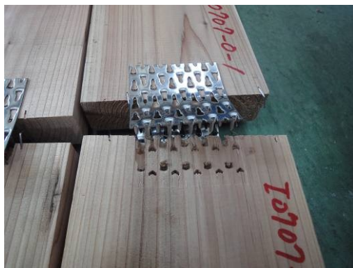
プレートの剥がれ
